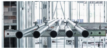
Versorgungsleitungen und Entwässerung
