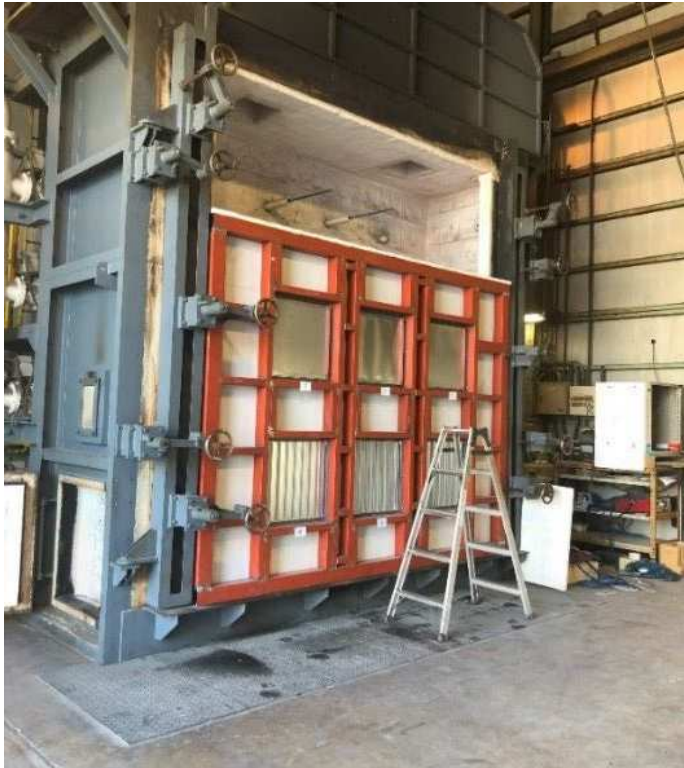
加熱炉の全景
