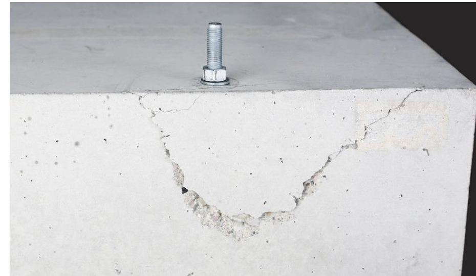
Rottura di bordo del calcestruzzo - Taglio
