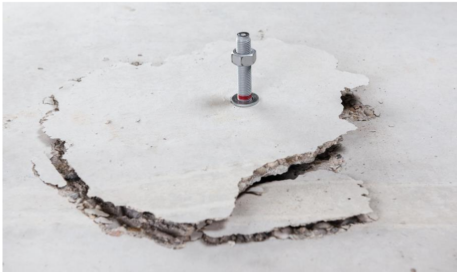
Rottura conica del calcestruzzo - Trazione
