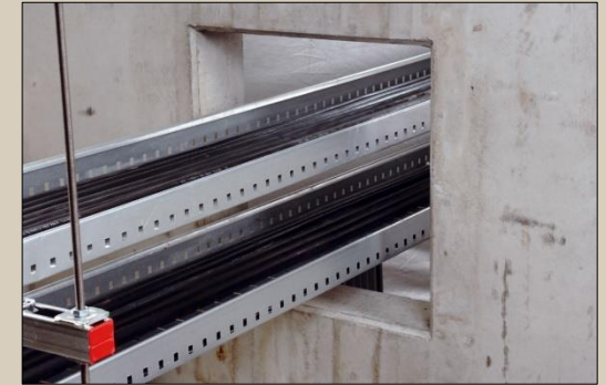
Chemin de câbles
