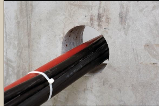
Faisceaux de câbles
